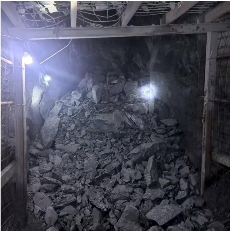
照片 1 事故区域现状
